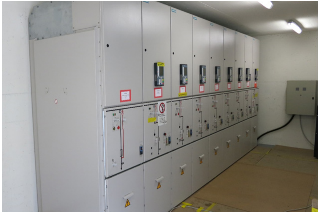
Mittelspannungsschaltanlage im neuen UW Ernen
