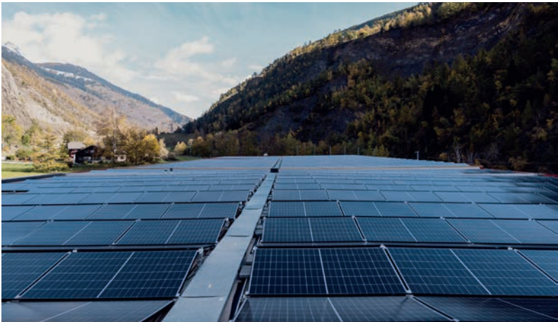
Sonnenkraft für Käsegenuss: Walker setzt auf eigene Energie – bald mit zweiter PV-Anlage und Batterie.
