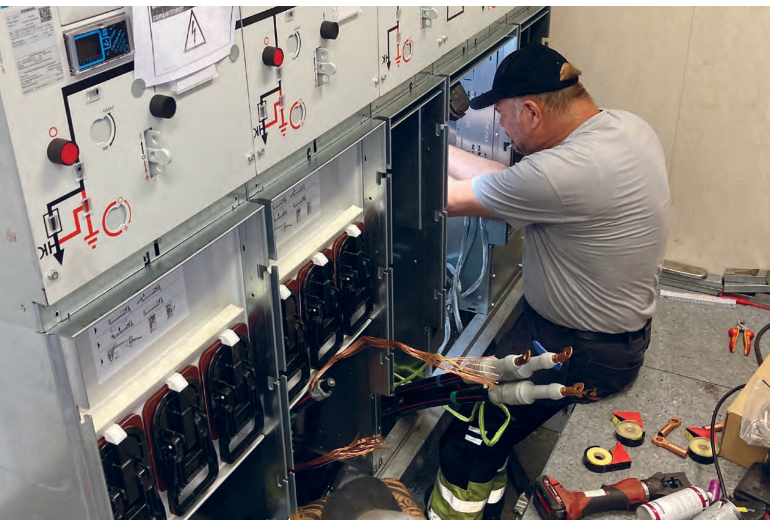
Ersatz Mittelspannungsanlage TS Westportal ■
