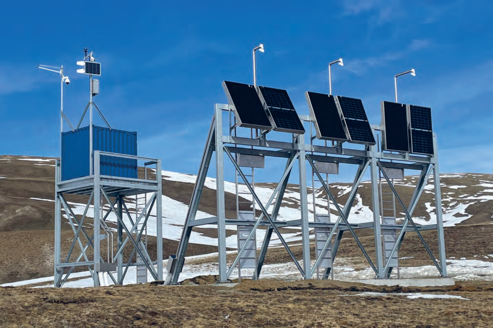
■ Photovoltaik-Testanlage Grengiols-Solar im Saflischtal
