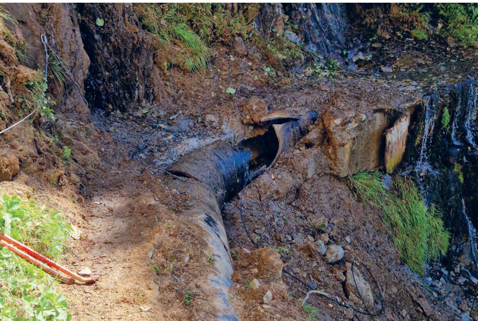
Beschädigte Hangleitung Schiessbach nach Felssturz ■
